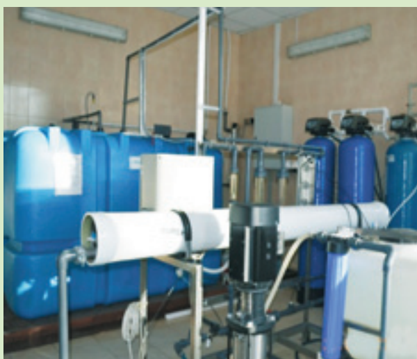
Рис. 3. Система очистки воды
